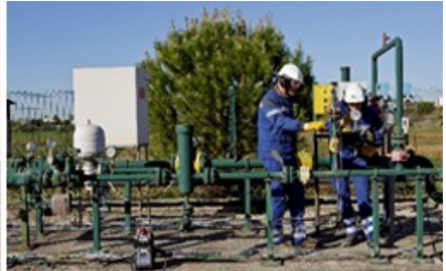
Salariés de GRTgaz en intervention sur un poste standard de détente livraison ©GRTgaz / Philippe DUREUIL
